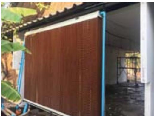
แผง EVAP เพื่อควบคุมอุณหภูมิและความชื้น
